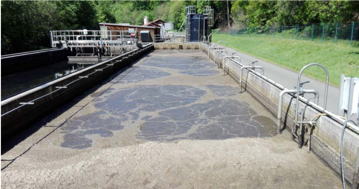
Das Belebungsbecken der Kläranlage Simmershausen erhält 2023 ein optimiertes Belüftungssystem und neue Gebläse.
